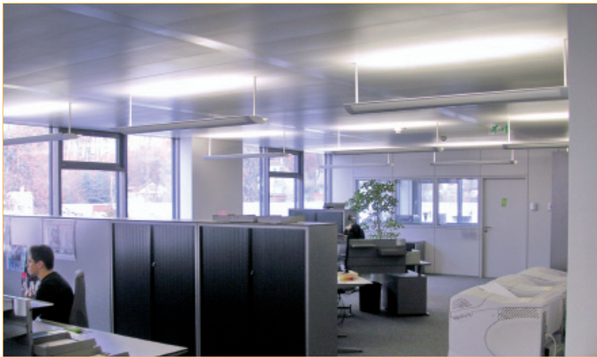
Aktuell beleuchten 180 ALADYNLED- Leuchtröhren die Grossraumbüros bei Phoenix Contact AG.
